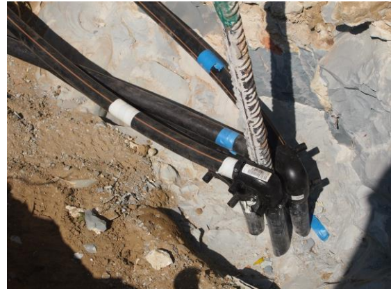
↳ Les tuyaux du système de géothermie sont intégrés dans les pieux de fondation en béton.
